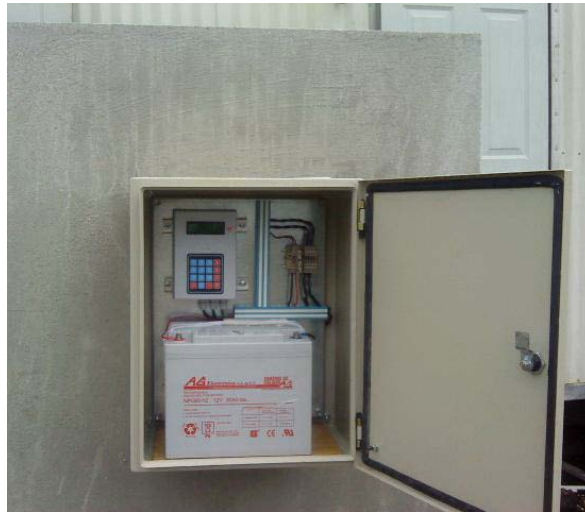
Gabinete de control.
